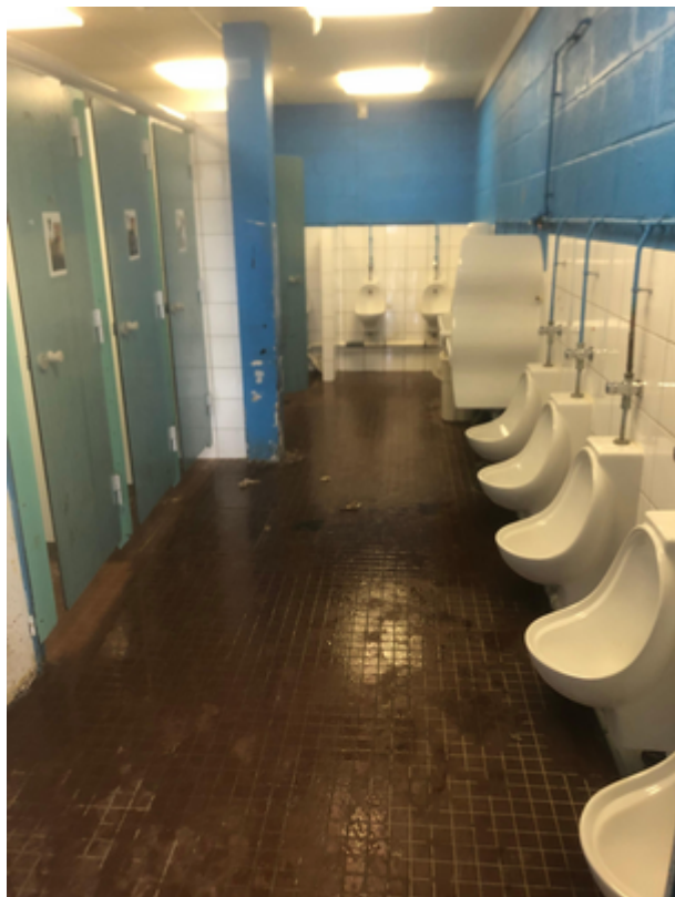
Toilettes des grands - flaque et fuite
