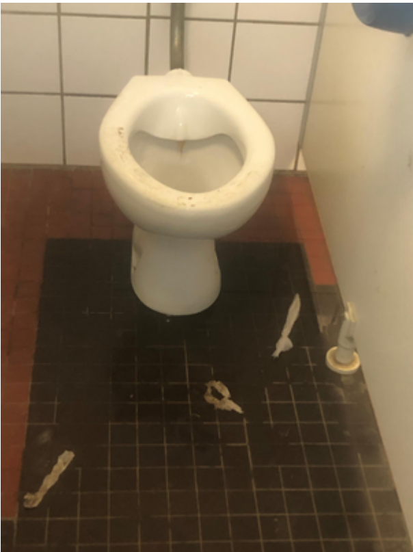
Toilettes des petits - fuites d'eau - flaques
