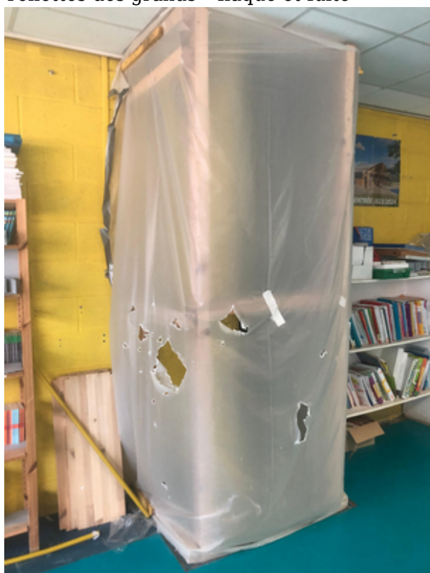
Cache misère dans la salle des maîtresses
