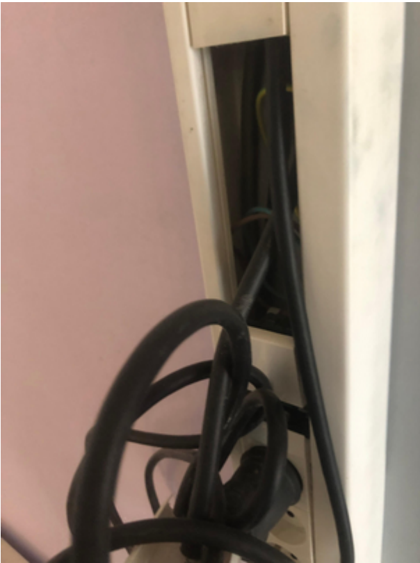
Prise et interrupteur défectueux dans une classe de CP
